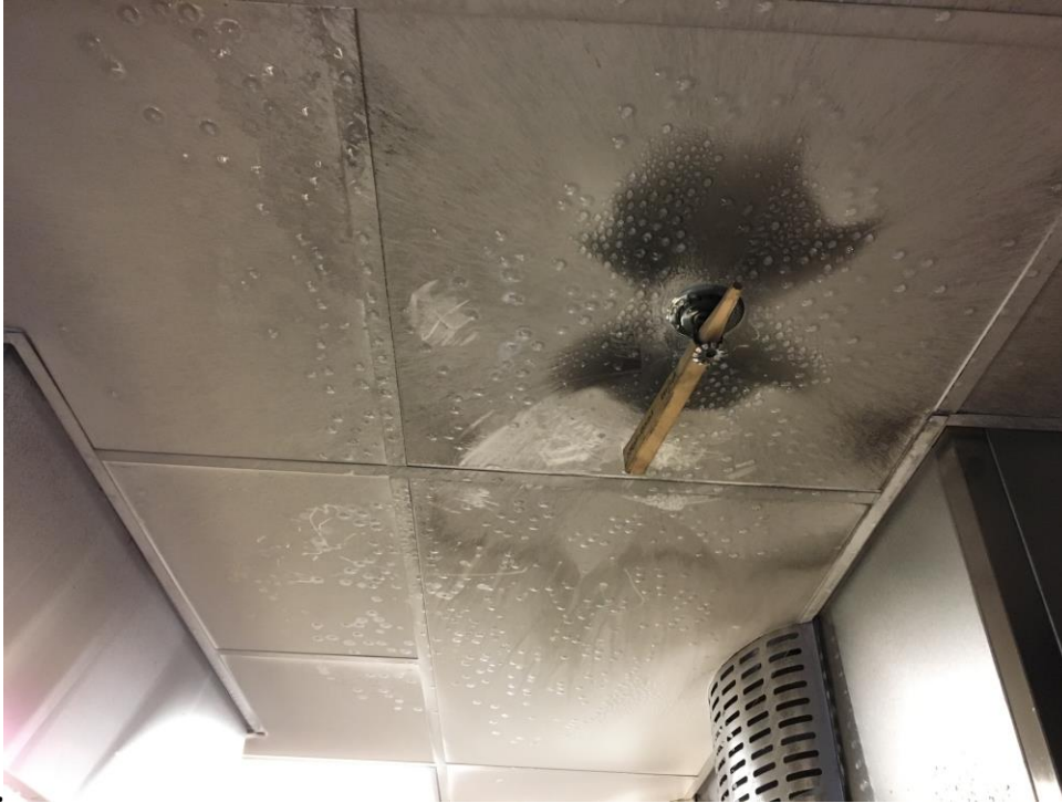
Tapaus10: Palokunnan asettama kiila lauenneeseen suuttimeen
