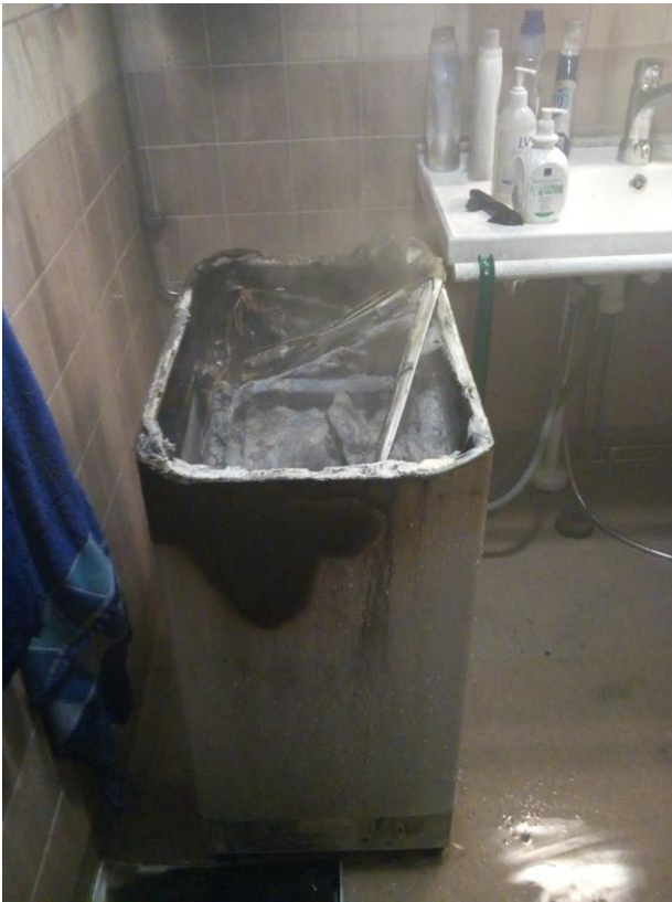
Tapaus 12: WC:ssä syttynyt pesukone palon jälkeen
